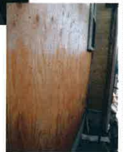
瑕疵保険を使い、 補修工事をした 一例です。
