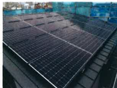
太陽光パネル
