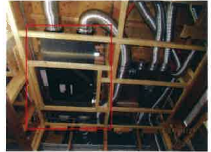
24 時間換気システム本体
